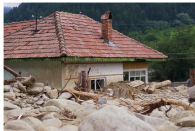
Geröll bis zum Dach
